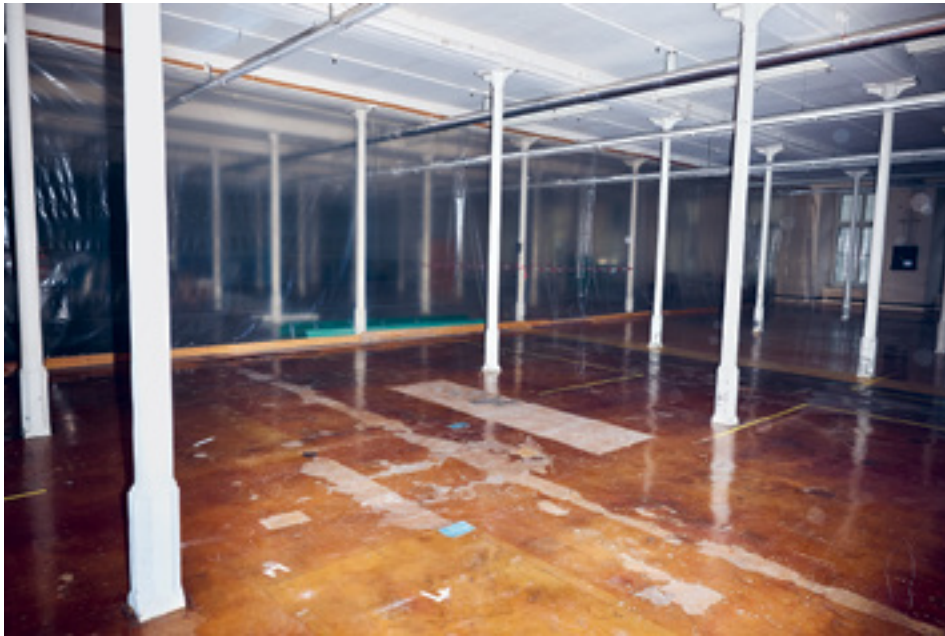
Die alte Tragstruktur des Hauptgebäudes soll in Holzsystembauweise erneuert werden. In den kommenden Jahren entstehen hier etwa 110 Wohnungen. / L'ancienne structure porteuse du bâtiment principal sera remplacée selon un procédé de construction modulaire en bois. Environ 110 appartements seront construits dans les années qui viennent.
