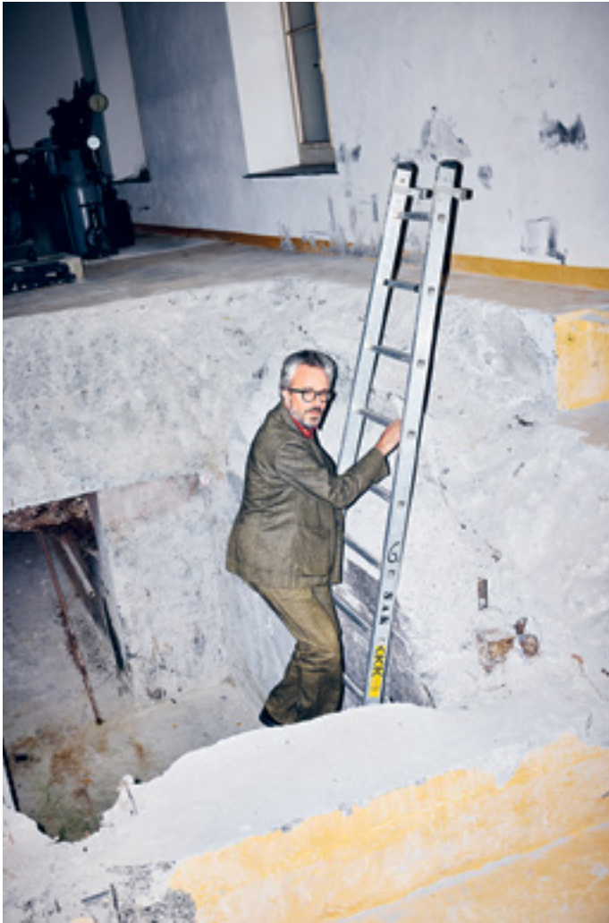
Druckstollen in der Zentrale «Felsen». Das ehemalige betriebseigene Wasserkraftwerk der Spinnerei Spoerry versorgte über längere Zeit auch das Dorf Flums mit Strom. / Galerie d'aménée dans la centrale Felsen. Pendant longtemps, l'ancienne centrale hydroélectrique de la filature Spoerry a aussi alimenté le village de Flums en électricité.
